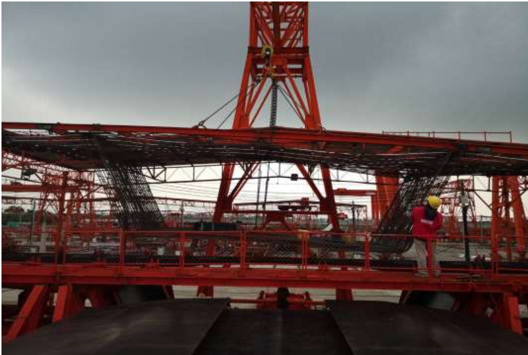
ตรวจสอบเหล็กเสริมก่อนลงโมลด์ Mould A4 ของ MLP04-11/2-TV3 (A)-S
